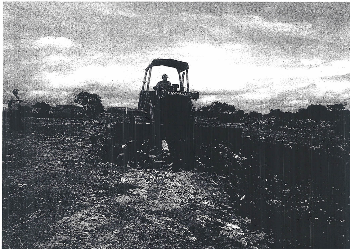
FOTO 02 – ENTERRAMENTO DOS RESÍDUOS SÓLIDOS
